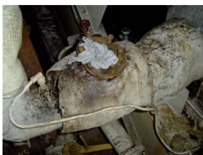
Figura A1.29 Detalle de calorifugado (textiles)
