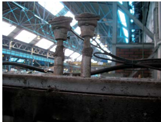
Figura A1.36 Aislamientos eléctricos en un horno
